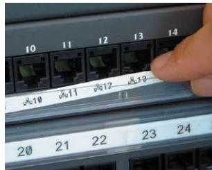
Etiquetas bloques de cableado
